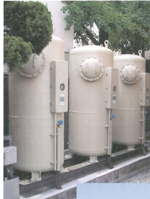
某電力会社(オイルタンク防火対策)
